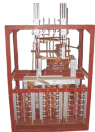
Rectifier 0-12 V/ 5000 A (60 KW)
